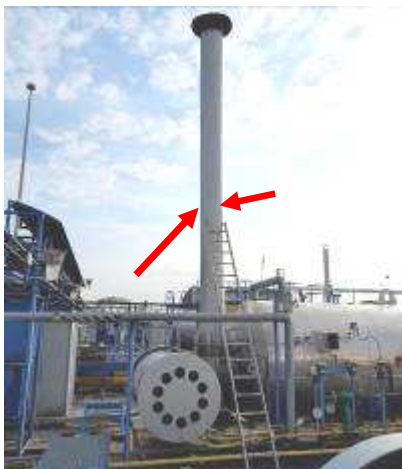
Obrázok č. 1 Pohľad na komín kotla OH 2A, vyznačenie meracích miest – ZS6
